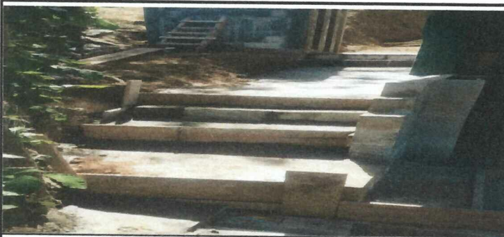
Foto 3: COLOCACION DE TORTA DE CEMENTO YA QUE CUANDO LLUEVE LOS ALUMNOS INGRESAN CON MUCHO LODO A LAS INSTALACIONES DEL ESTABLECIMIENTO
