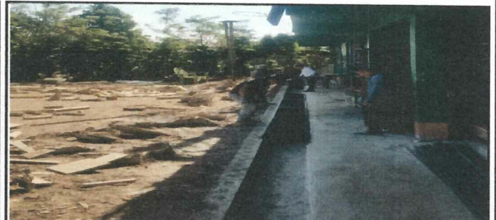
Foto 2: SE NECESITA LA COLOCACION DE REJILLAS DE METAL YA QUE ACUMULA MUCHA BASURA CUANDO LUEVE
